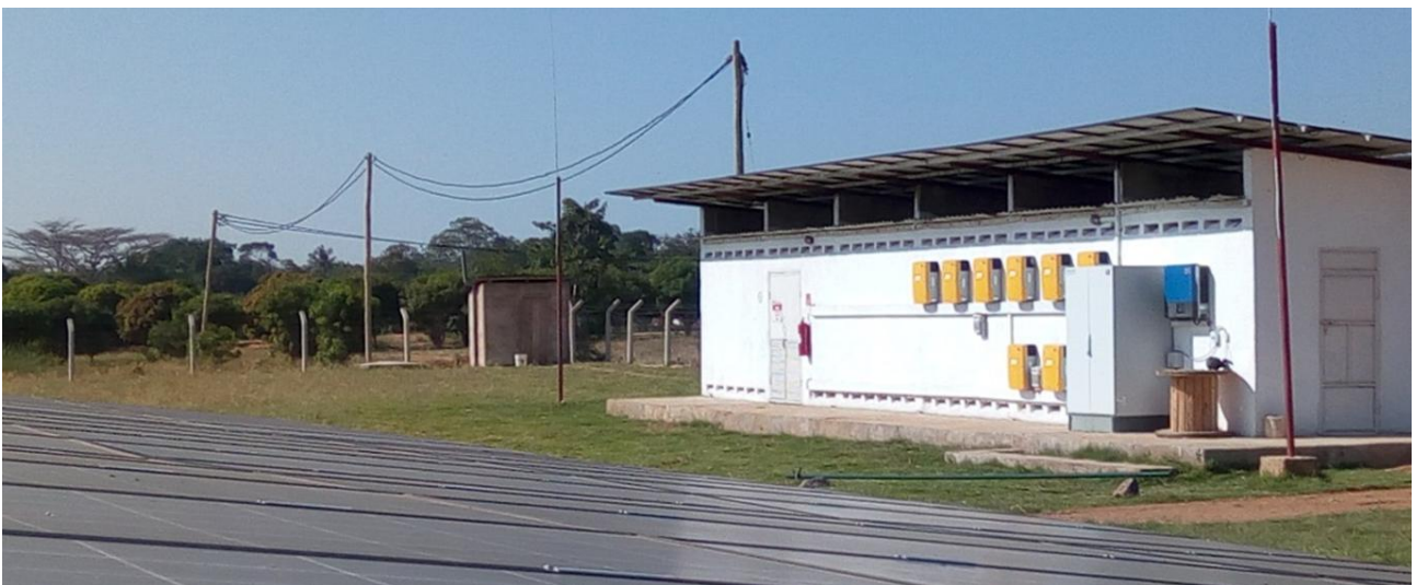
Abbildung 7. Solar-Batterie-Kraftwerk und Verteilnetz der Micro Utility JUMEME auf Ukara Island, im Viktoriasee in Tansania. JUMEME ist ein tansanisches Unternehmen mit Beteiligung von deutschen und europäischen Investoren.
